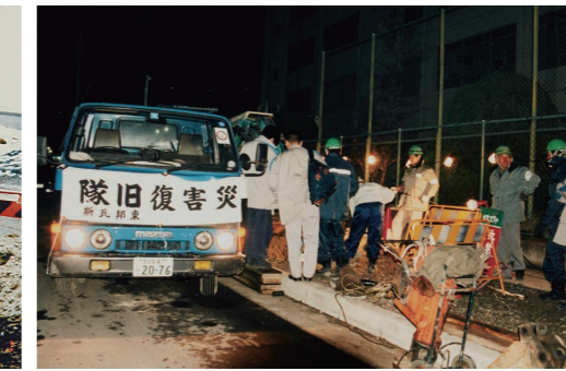
被災地での復旧活動(阪神・淡路大震災)
