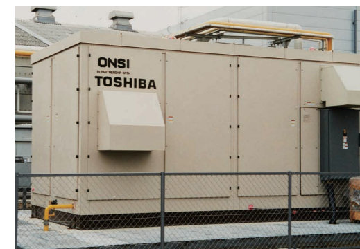
デンソー西尾製作所に導入した燃料電池
